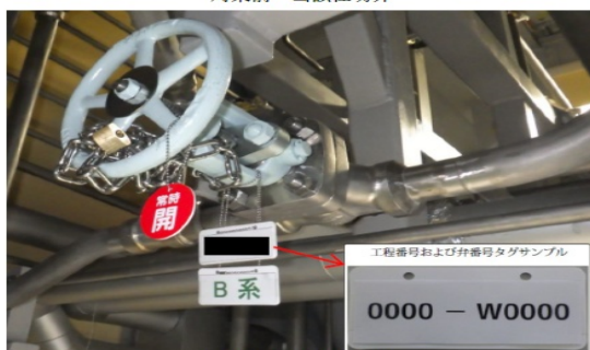
対策後 当該仕切弁
