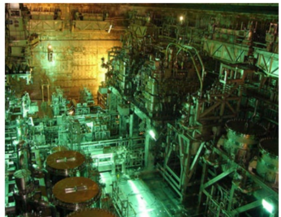
ガラス固化設備(日本原燃HPより)
