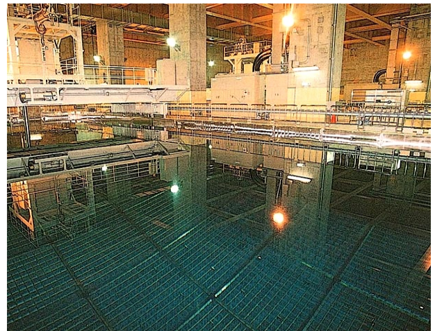
使用済燃料貯蔵プール（日本原燃のホームページより）
