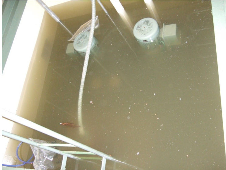
(1号炉のタービン建屋地下5階部分に水が貯留)
