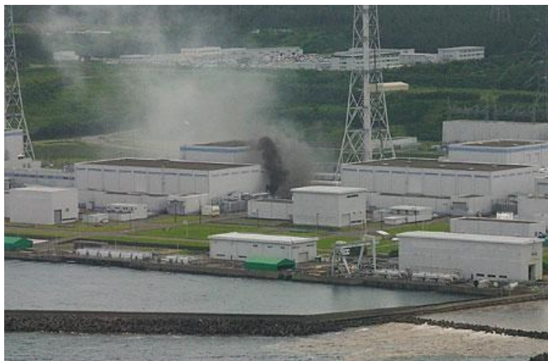
(変圧器火災の状況 報道写真より)
