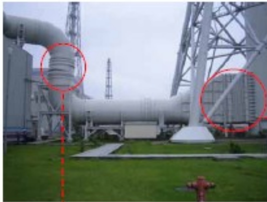
K1 排気ダクト外観
