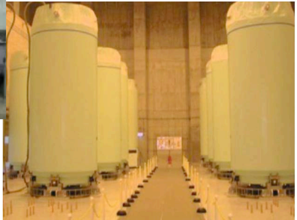
東海第二原発中間貯蔵施設(24基)
