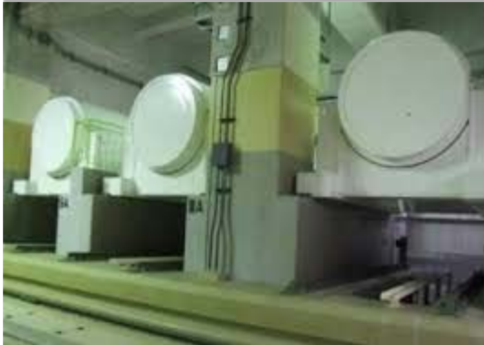
福島第一原発乾式中間貯蔵施設(9基) 2011年3月11日 津波が建屋に入り、容器が水没した。
