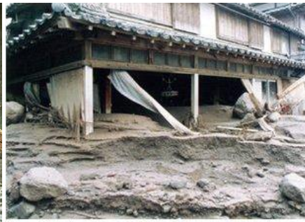
土石流被害を受けた家屋
